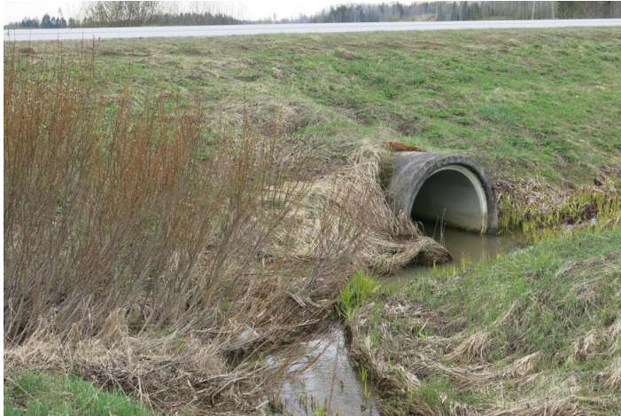
Kuivatusojan rumpu maantien ali.
