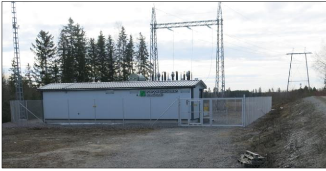
Alueella on 110 kV:n muuntoasema.
